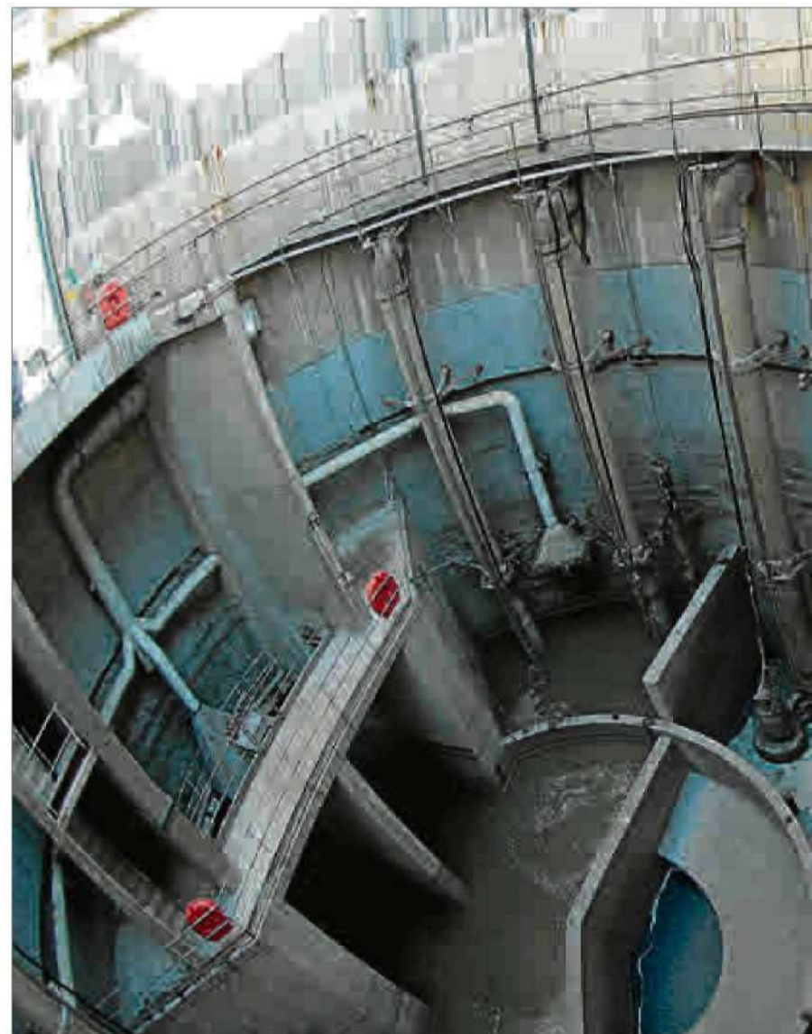
El Colector Central de Murcia, propiedad de Esamur, está gestionado por Aguas
